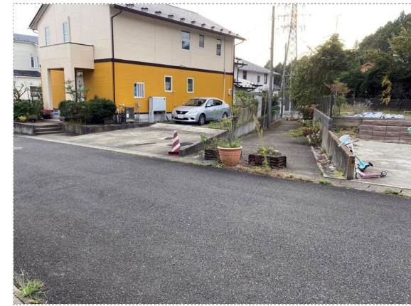
写真3 東側部 頭部方向 変状ほぼなし
