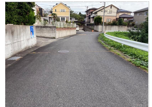
写真8 中央 東方向 路面ひび割れ微小
