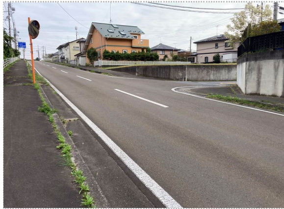
写真23 No.15-2北側部 路面変状ほぼなし
