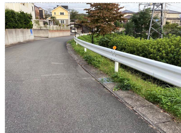
写真10 西側部 のり肩微小沈下
