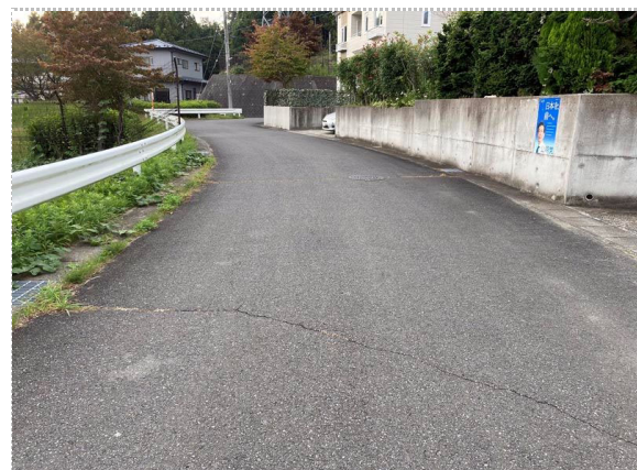
写真9 中央 西方向 曲線的な路面ひび割れ
