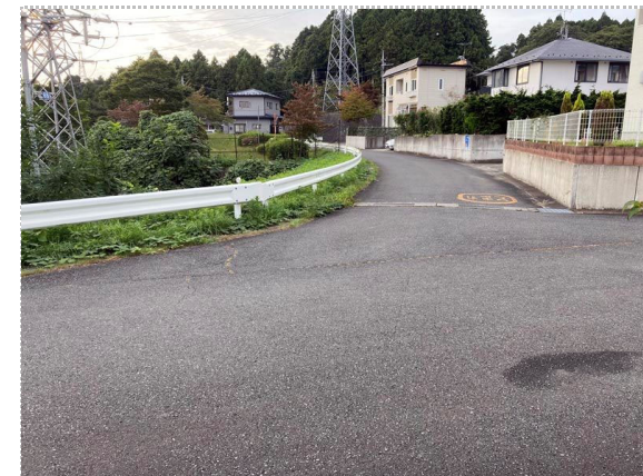
写真7 東側部 中央方向 路面ひび割れ微小
