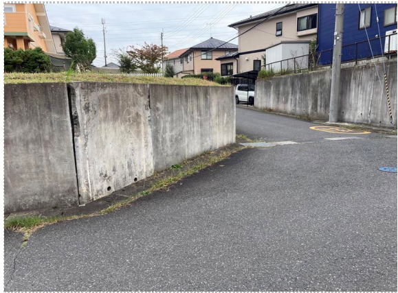
写真22 No.15-2頭部 コンクリート土留め目開き微小
