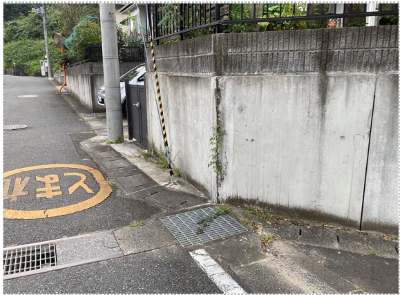
写真24 No.15-2頭部北側 コンクリート土留め目開き微小
