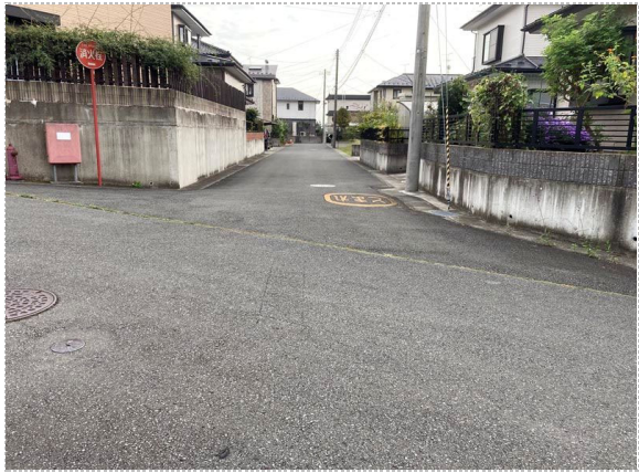
写真17 頭部範囲外 主測線方向 変状ほぼなし
