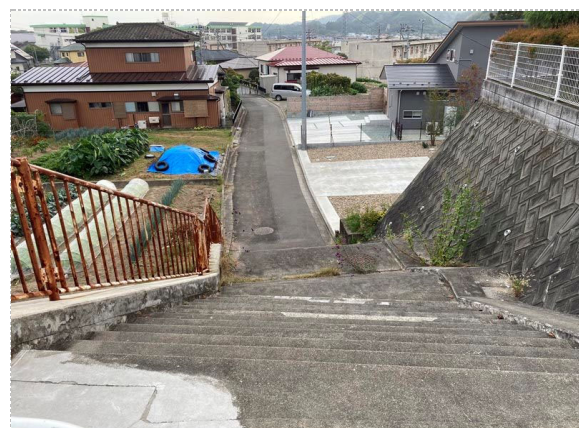
写真13 西側部 範囲外 階段ひび割れ微小
