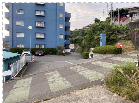
写真13 東側部中央方向 側溝常時湿潤
