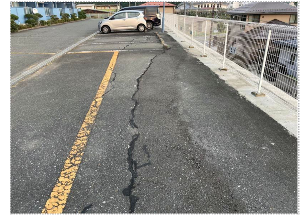
写真20 中央末端付近 舗装沈下ひび割れ顕著
