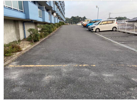
写真18 西側部 中央方向 舗装凹凸微小
