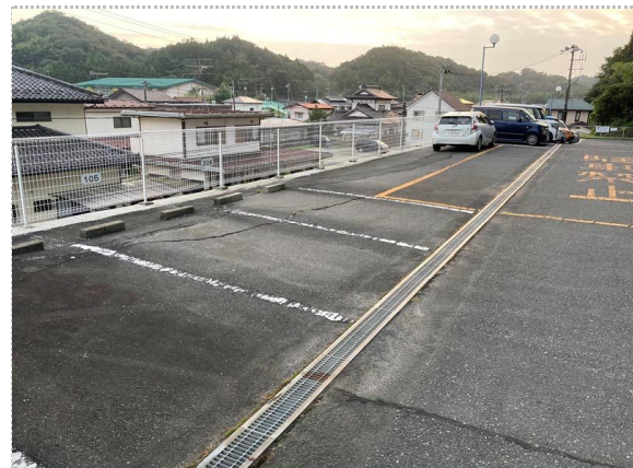
写真21 中央末端付近 舗装沈下ひび割れ顕著
