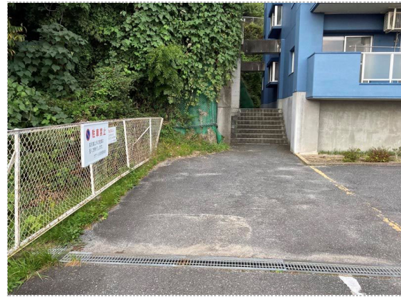
写真17 西側部 植生繁茂部に露岩 舗装凹凸微小
