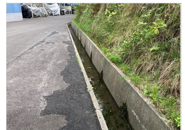
写真16 頭部中央 のり尻から常時湧水
