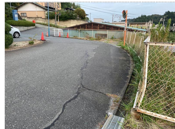
写真23 東末端付近 舗装沈下ひび割れ顕著
