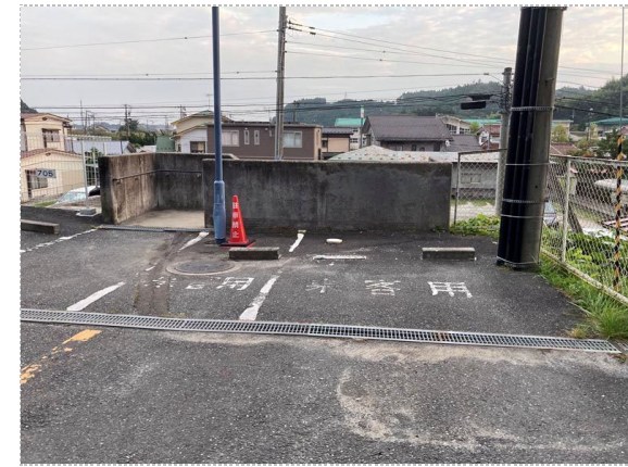
写真3 西側部上面 舗装沈下とひび割れ
