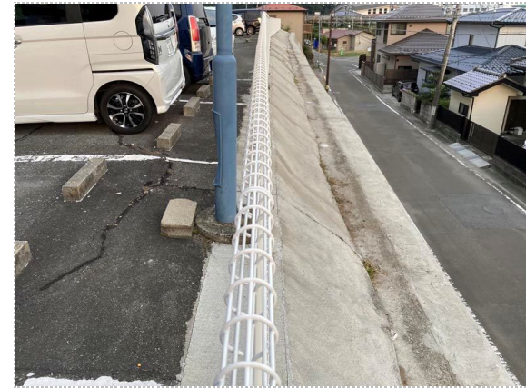
写真19 中央末端付近 新設モルタル のり肩ひび割れ
