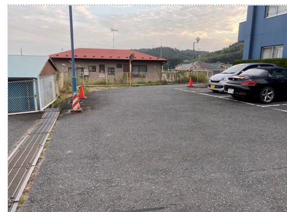
写真14 東側部 のり肩微小沈下
