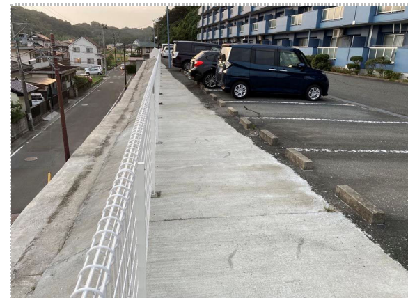
写真22 中央末端付近 新設モルタルひび割れ微小
