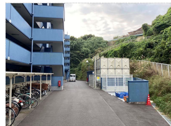
写真15 頭部東側 中央方向 変状ほぼなし
