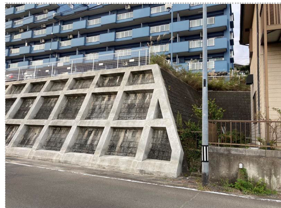
写真9 末端東側 ブロック積に変状ほぼなし
