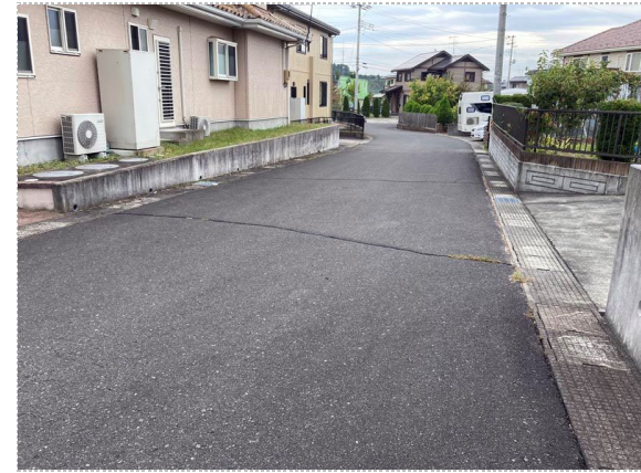
写真18 中央上流側 路面ひび割れやや顕著
