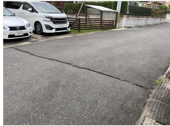
写真17 西側部頭部付近 路面ひび割れ幅大
