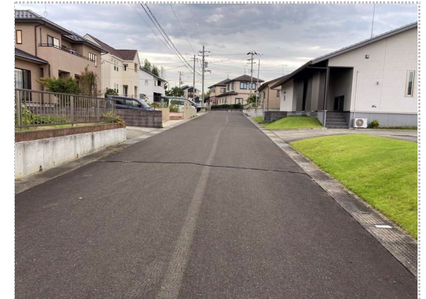
写真24 中央東方向 路面ひび割れ幅大
