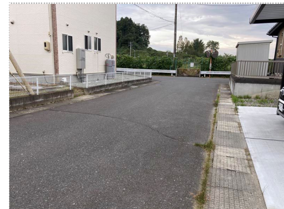
写真27 西側部 調整池方向 曲線的な路面ひび割れ
