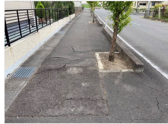
写真3 西側部 歩道波うち顕著 街路樹根の影響あり
