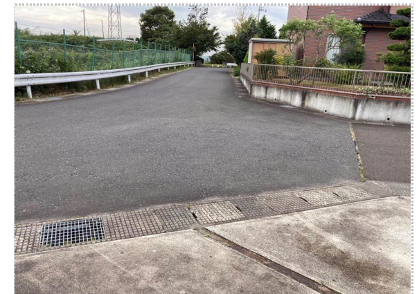
写真28 西側部 調整池上部 路面施工継ぎ目開き小
