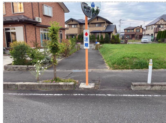
写真9 頭部主測線方向 歩道ひび割れ
