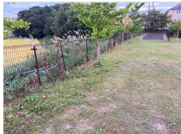
写真41 末端のり肩中央 表層小崩壊 フェンス曲がり
