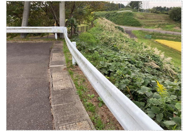
写真36 同左のり肩 側溝微小沈下
