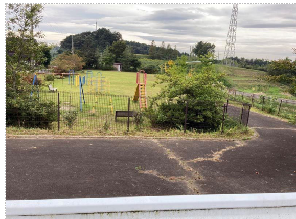
写真37 東側部下流側 中央方向 路面ひび割れ幅大
