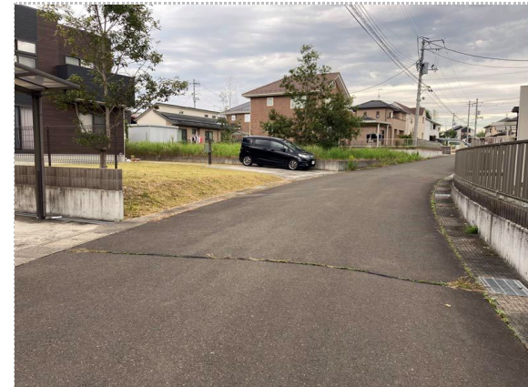
写真22 西側部中央方向 古い路面ひび割れ幅大
