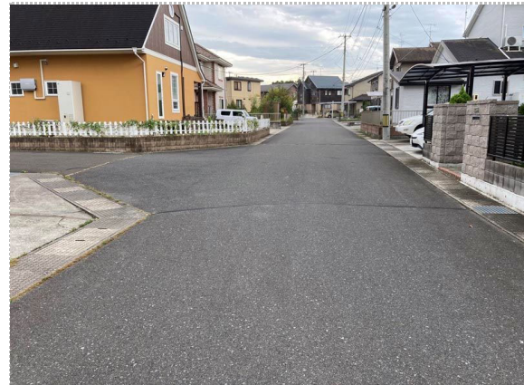
写真21 西側部付近 路面ひび割れ微小
