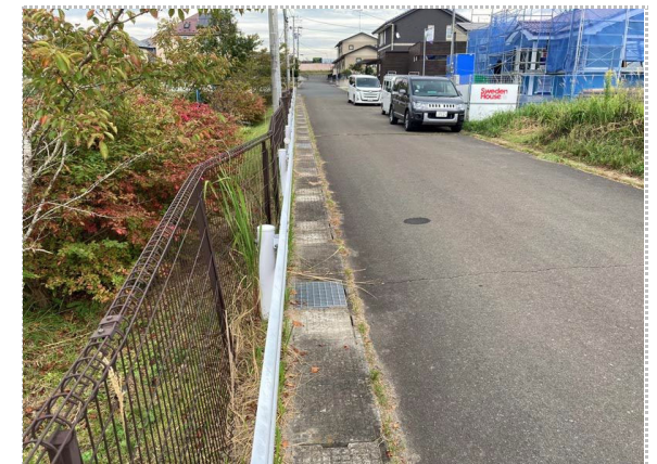
写真40 中央下流側 路面ひび割れ微小 フェンス曲がり顕著
