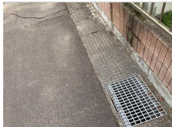
写真5 西頭部 側溝に常時帯水
