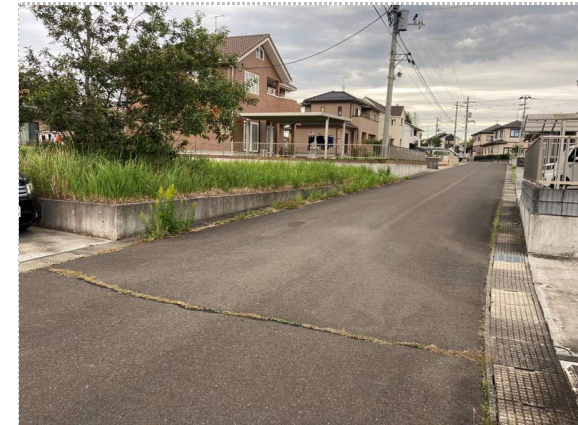
写真23 中央 古い路面ひび割れ幅大
