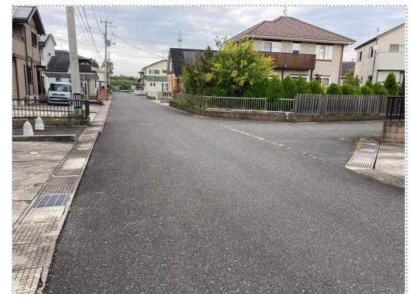
写真16 西側部頭部付近 路面ひび割れ微小
