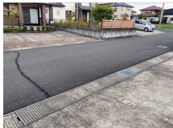
写真13 頭部中央付近 路面ひび割れ幅大 補修後も進行
