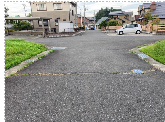
写真11 東側部 頭部付近 古い路面ひび割れ
