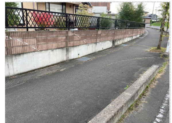
写真8 頭部西側 路面ひび割れ 宅地外壁ひび割れ
