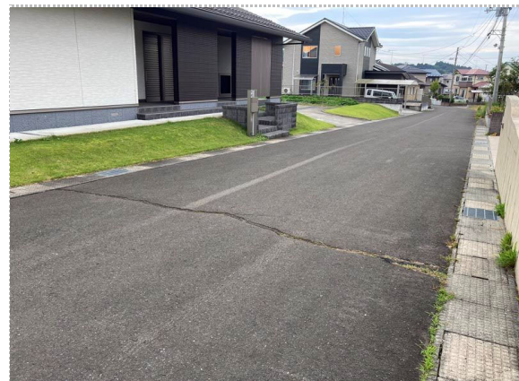
写真25 東側部 路面ひび割れ幅大
