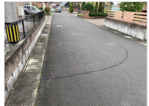
写真12 東頭部付近 曲線的な路面ひび割れ
