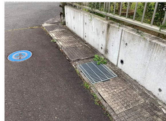
写真26 東側部 側溝微小沈下
