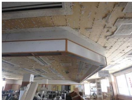
水没後に落下したロックウール吸音天井板
