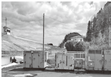
貝殻塚2地区の仮設ポンプ場
