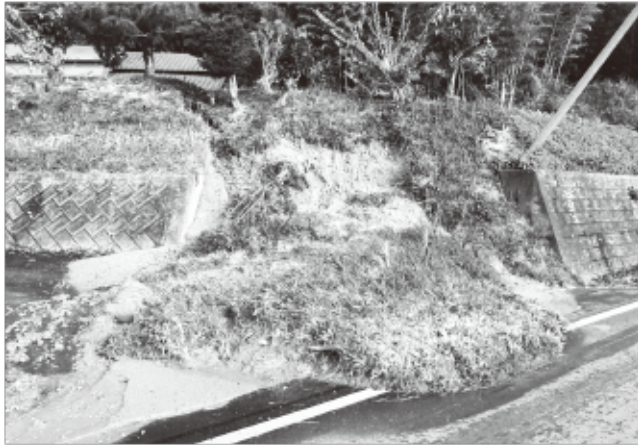
台風19号被害(土砂が道路に流出)
