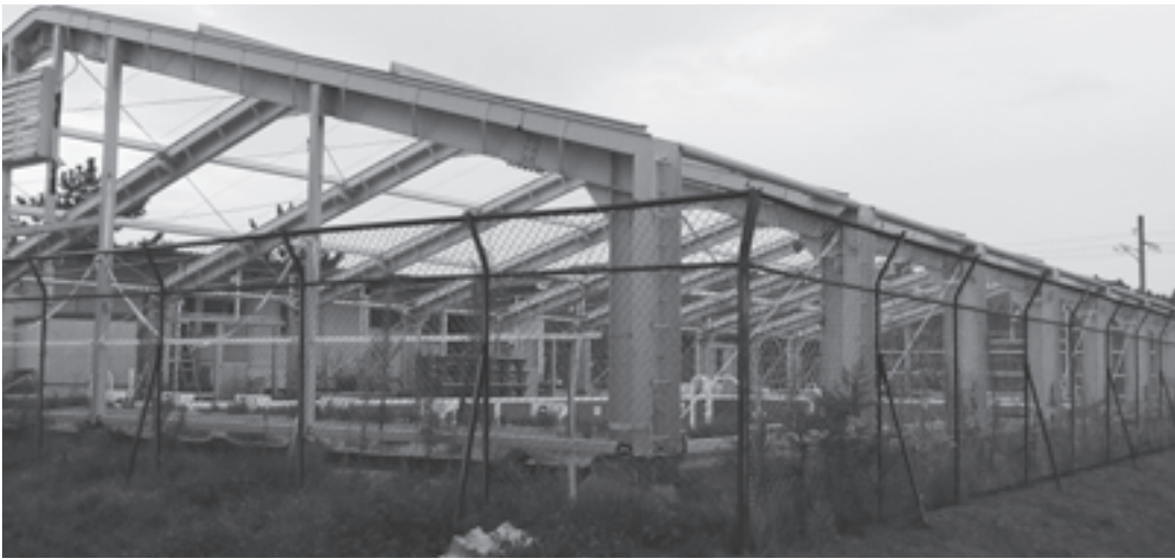
被災により解体される海洋センタープール跡地に屋外屋根付多目的運動場が新設される
